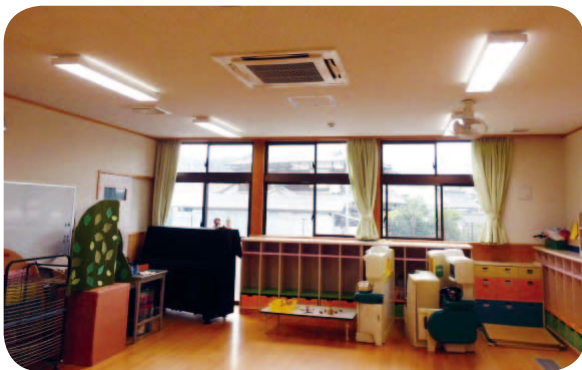
内子幼稚園の冷暖房設備
