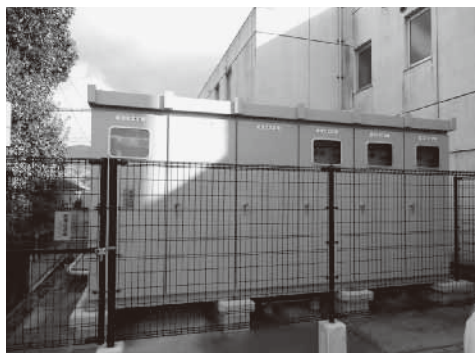
役場本庁の非常用自家発電設備
