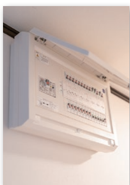
ブレーカーの場所も確認
