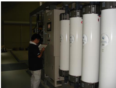
論田浄水場膜ろ過設備
