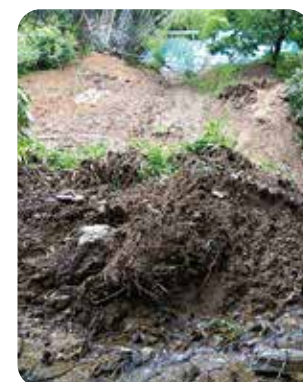
台風2号による大雨で県道崩落
