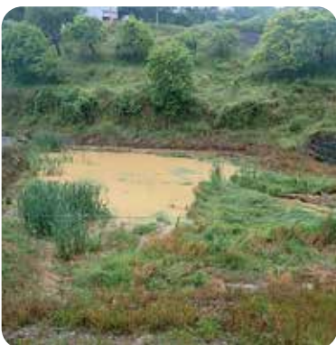
土砂が堆積した沈砂池
