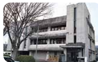
壁の剥離がある内子分庁横の建物
