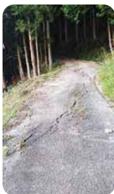
陥没している町道
