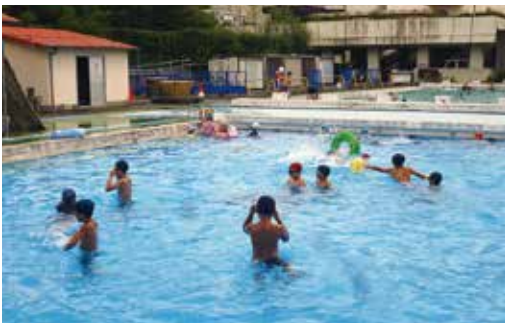
老朽化が進む五十崎町民プール
