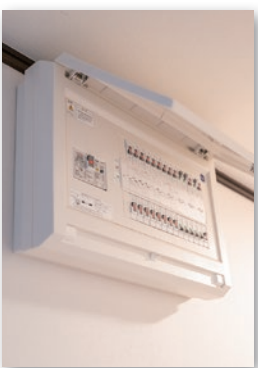
ブレーカーの場所も確認
