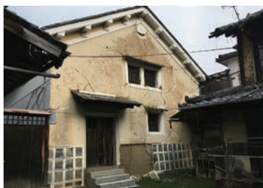
傷みの進む歴史的建造物
