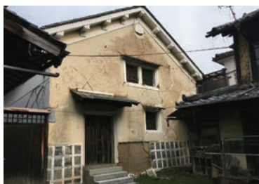
傷みの進む歴史的建造物
